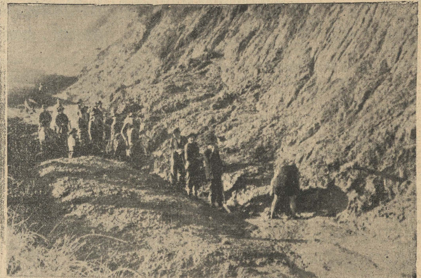
Esta fotografía permite apreciar en toda su gravedad el derrumbe del cerro frente a Punta de Parra. La tierra tapó la línea por completo. Advierta el lector que la vía está precisamente en la dirección en que están parados estos trabajadores, que cumplen su labor con mucha dificultad, ya que a cada momento la tierra se corre con la humedad excesiva que dejó la lluvia.
